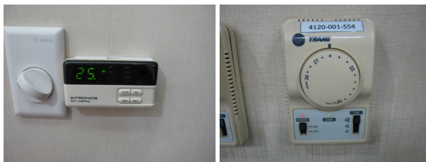
รูปที่ 3 การตั้ง Thermostat ที่อุณหภูมิปรับอากาศใช้งานปกติ
